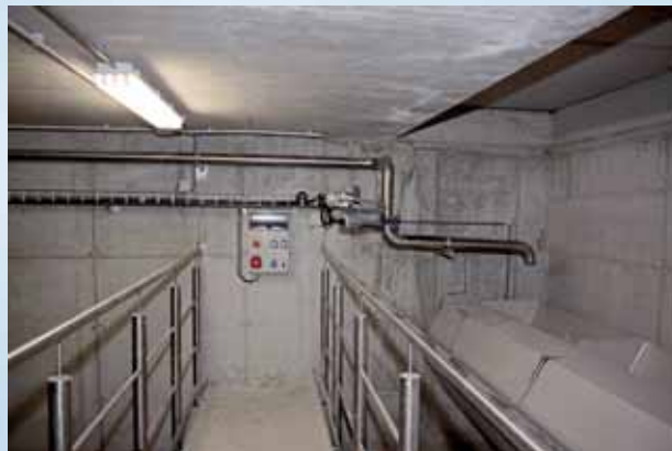
Vyplachovací klapka v retenční nádrži Přerov RN - OK 1 Na
